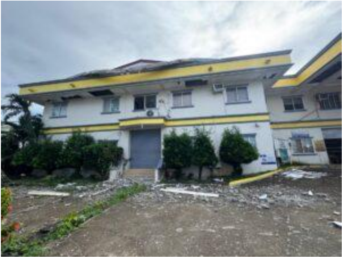
Photo 1: Damage to San Remigio municipal hall in the town center (Población).
